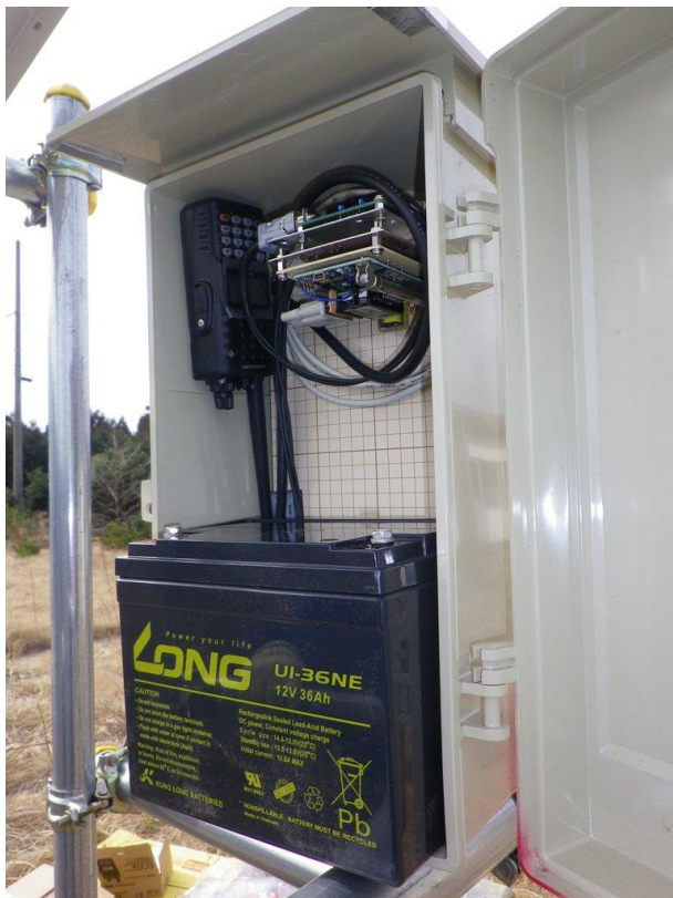
写真5 パケット通信機器とバッテリー
